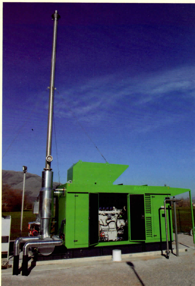
Figura 3 – Cogeneratore da 100 kWp, una taglia comune a molti impianti progettati dalla General Contract.
